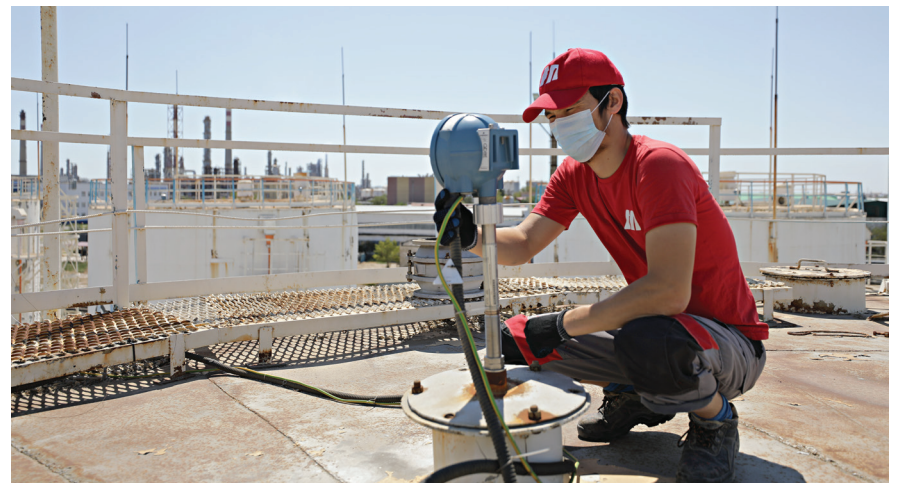
На фото: работа с многозонным преобразователем температуры с датчиком подтоварной воды
