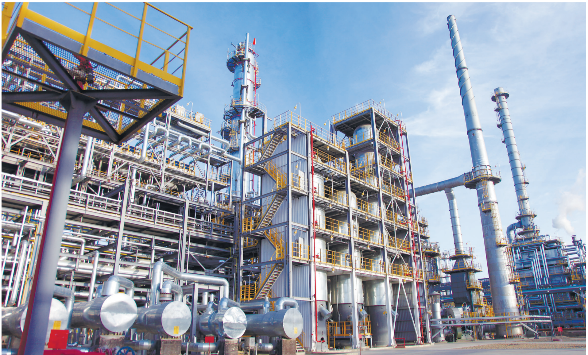
Установка PRIME D Фото Данияра Мухамбетова
