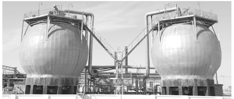
На фото: электродегидраторы (ЭЛОУ) установки АТ-2
