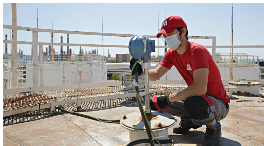
На фото: работа с многоканальным преобразователем температуры с датчиком подтоварной воды
