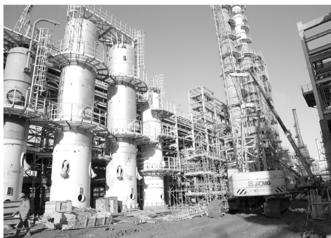
Колонное оборудование установки CCR
